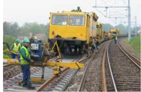
Longs rails soudés sur traverses béton
