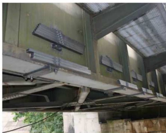
Absorbeur sur platelage
